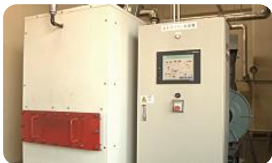
■温室ボイラーの燃料へ
