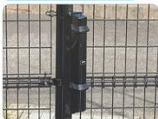
侵入者をセンサーで管理
